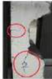
Figura 8. Daño en la unión de la columna y el collar plástico 2.
